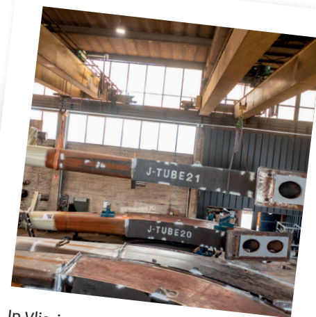
In Vlissingen (NL) plaatst TM Edison de J-Tubes in de betonnen caissons die de fundering van het energie-eiland vormen.
